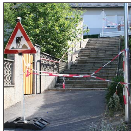
Die Stiegenanlage musste wegen der schadhafte Stellen vorübergehend abgesperrt werden.
